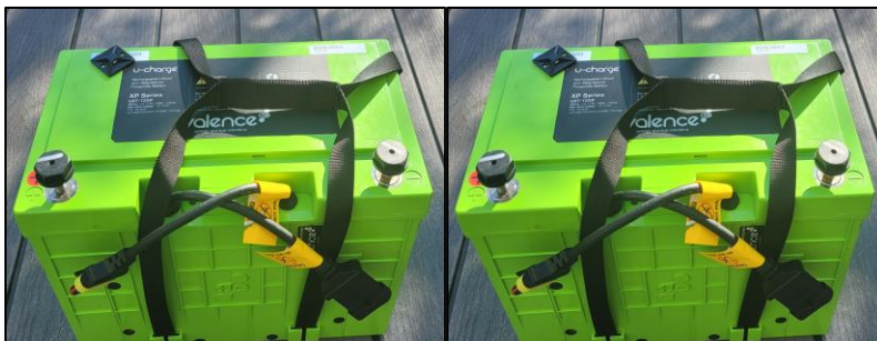
(2ea.) Valence Batteries (276Ah)
